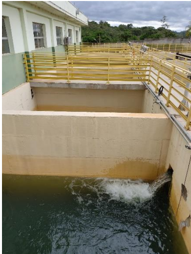
Figura 30. Sistema de Filtragem.
