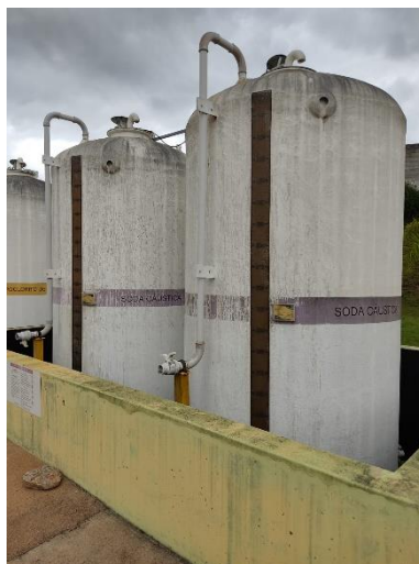
Figura 40. Tanques de Soda Cáustica.
