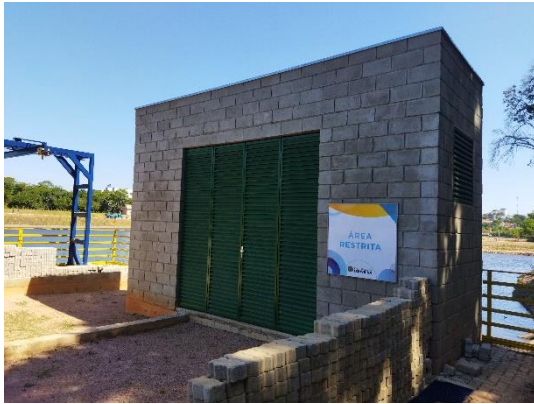
Figura 15. EEAB da captação do Córrego do Fetá - Casa de equipamentos e elétrica.
