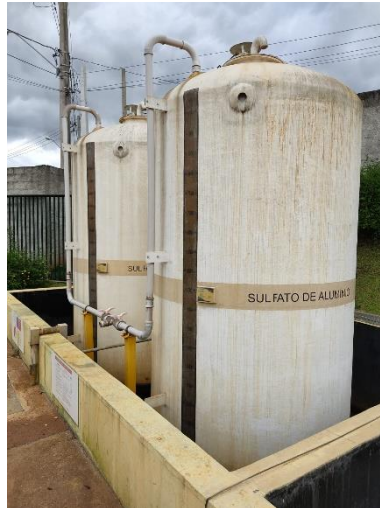
Figura 39. Tanques de Sulfato de Alumínio.
