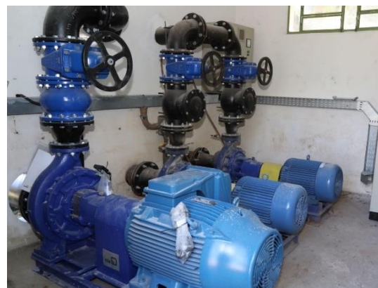
Figura 18. EEAB da captação do Córrego Água do Buracão.
