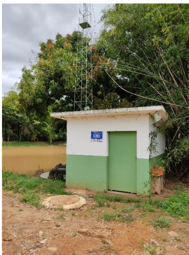
Figura 17. Casa de Bombas da EEAB da captação do Córrego Água do Buracão.
