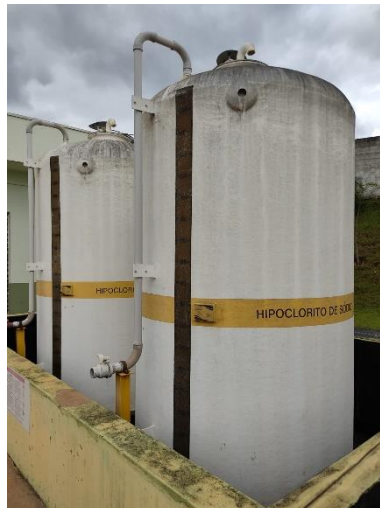
Figura 41. Tanques de Hipocloreto de Sódio.
