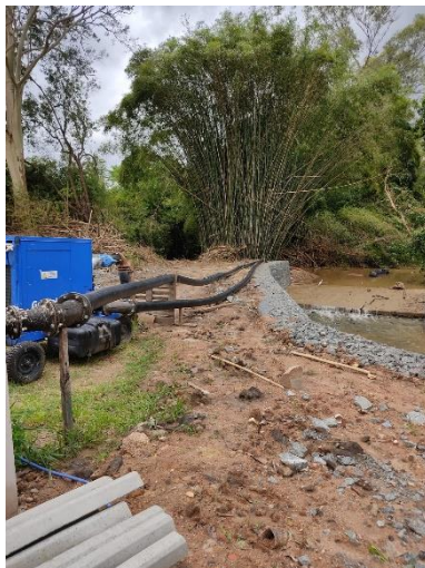
Figura 12. Tubulações da captação do Rio Capivari.
