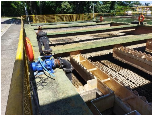
Figura 34. Estação de Tratamento de Água - ETA I – Bomba para recirculação.
