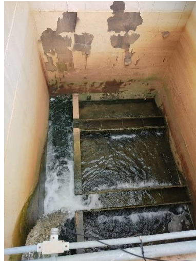
Figura 31. Sistema de Filtragem.
