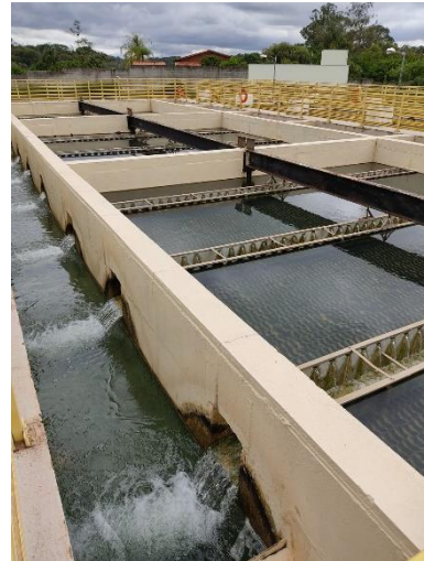
Figura 29. Saída dos Decantadores
