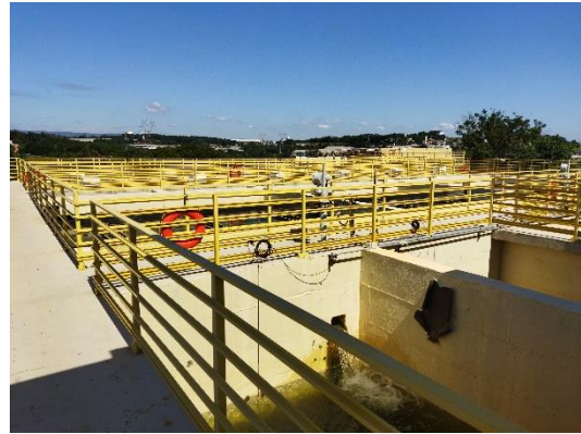
Figura 33. Estação de Tratamento de Água - ETA II.
