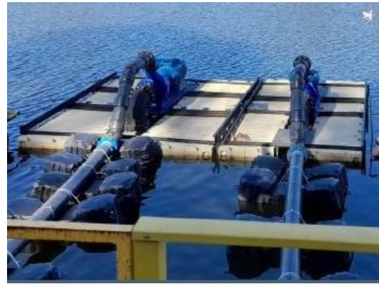
Figura 16. EEAB da captação do Córrego do Fetá - Conjuntos Motobomba flutuantes.
