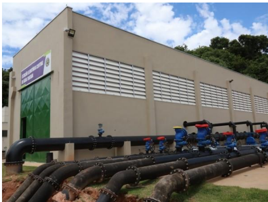
Figura 43. Estação Elevatória de Água Tratada Central.
