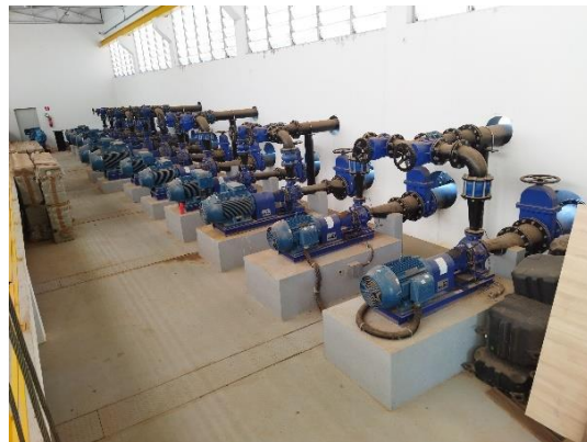
Figura 44. Estação Elevatória de Água Tratada Central.
