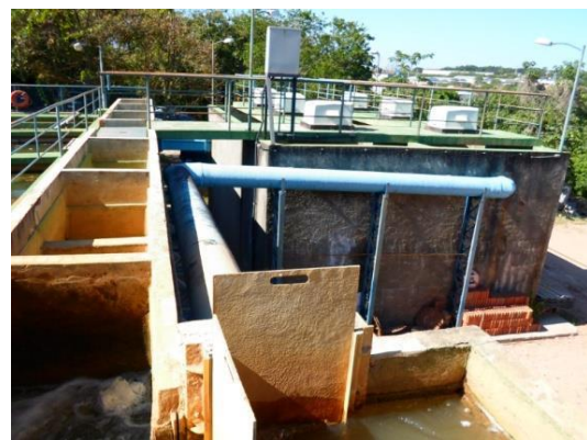
Figura 35. Estação de Tratamento de Água - ETA I.
