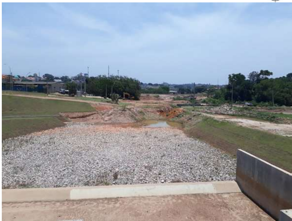
Foto 12. Vista para jusante a partir do vertedouro de canal de restituição parcialmente construído. Notar que as laterais do canal de restituição não foram protegidas com enrocamento conforme previsto em projeto.
