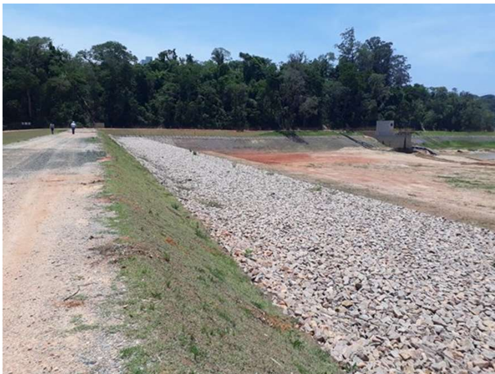
Foto 4. Vista do talude de montante da barragem. Notar que a proteção não chega até a crista conforme concepção original de projeto.
