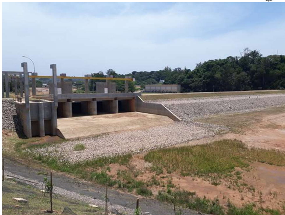
Foto 6. Vista por montante do vertedouro e barragem. A esquerda a tomada d'água seletiva.
