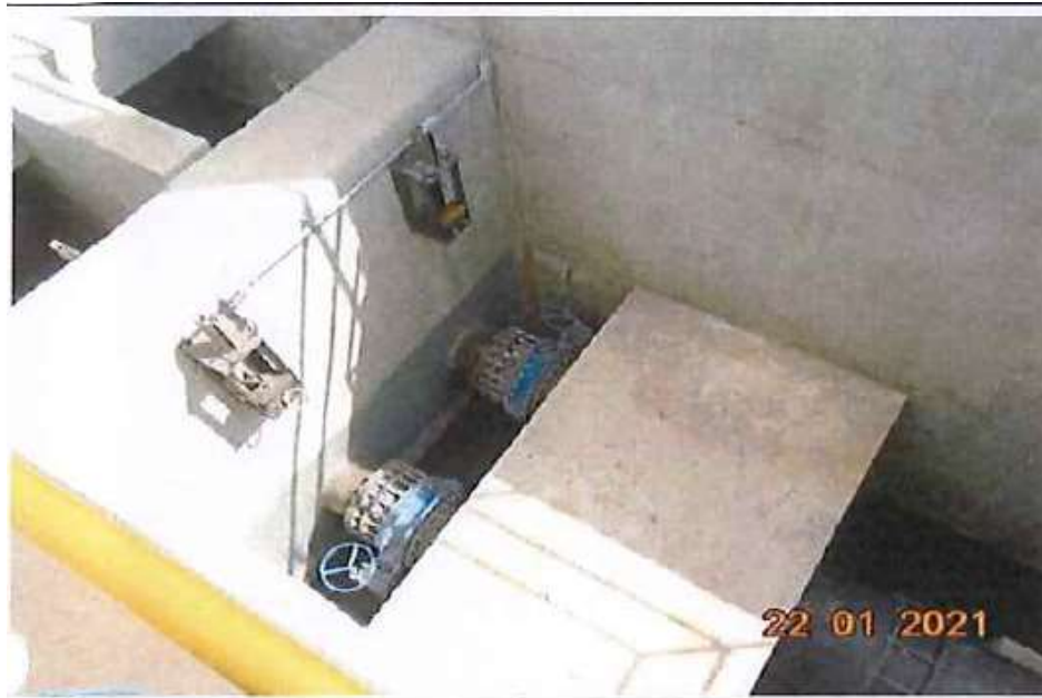
Foto 2.5 - Vista das válvulas dispersoras e caixa dissipadora.
