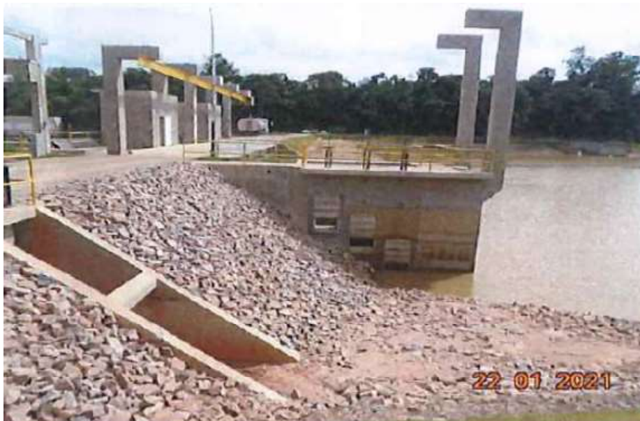
Foto 2.4 - Vista lateral da Tomada de água seletiva ( três comportas) que alimenta as válvulas dispersoras.
