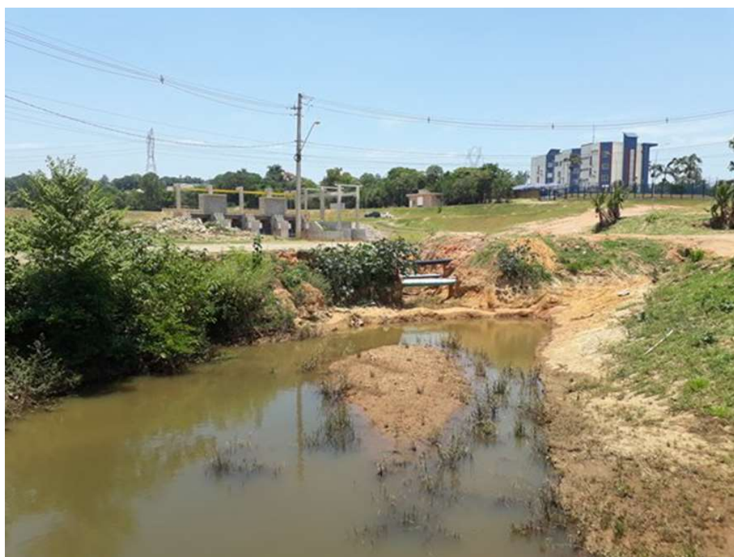
Foto 13. Vista de jusante para montante do canal de restituição parcialmente escavado. Notar ao fundo o vertedouro.
