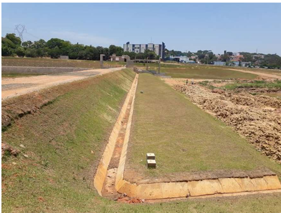
Foto 5. Vista da crista e do Talude de jusante da Barragem, a partir da margem direita. Notar que ainda não foi realizada proteção conforme projeto, sendo usado grama ao invés de enrocamento na saída dos filtros. Notar canaleta de drenagem com saída sem proteção. Observar piezômetros instalados.
