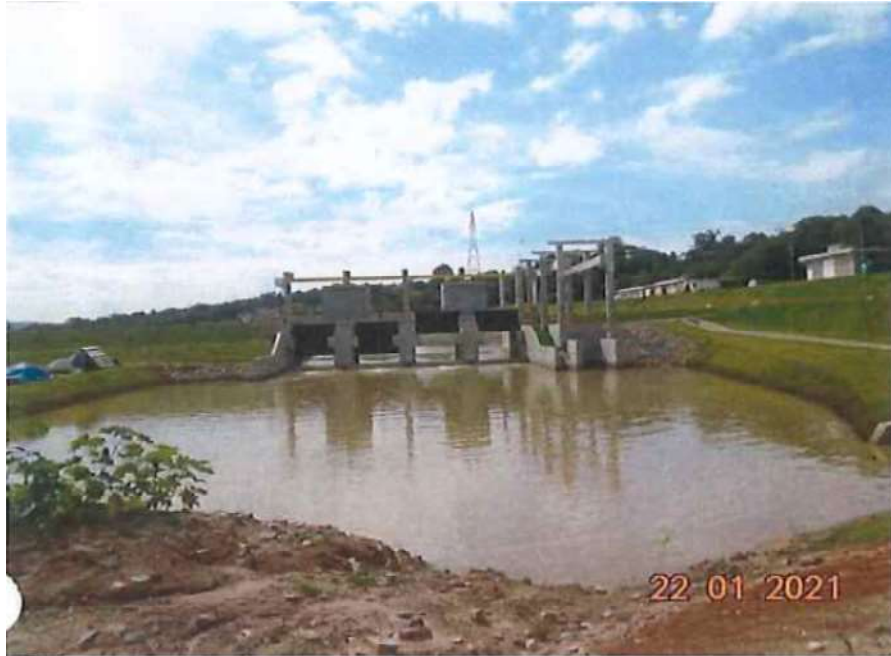
Foto 2.1 - Vista do Vertedouro por jusante. Notar que as 4 comportas se encontram abertas
