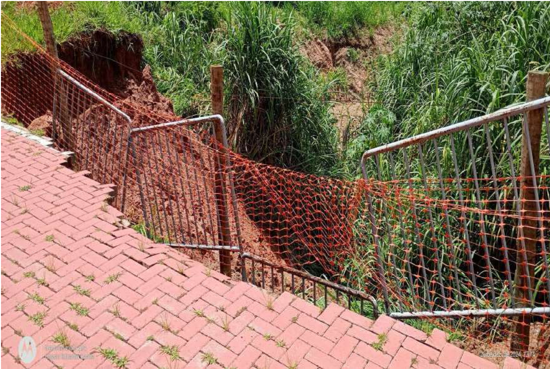
Imagem 04 – Processo de Erosão Hídrica – Área de Lazer do Trabalhador
