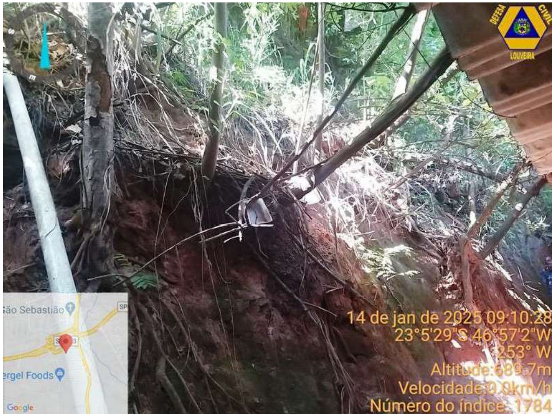
Imagem 16 – Processo de Erosão em Talude - Jardim Vera Cruz
