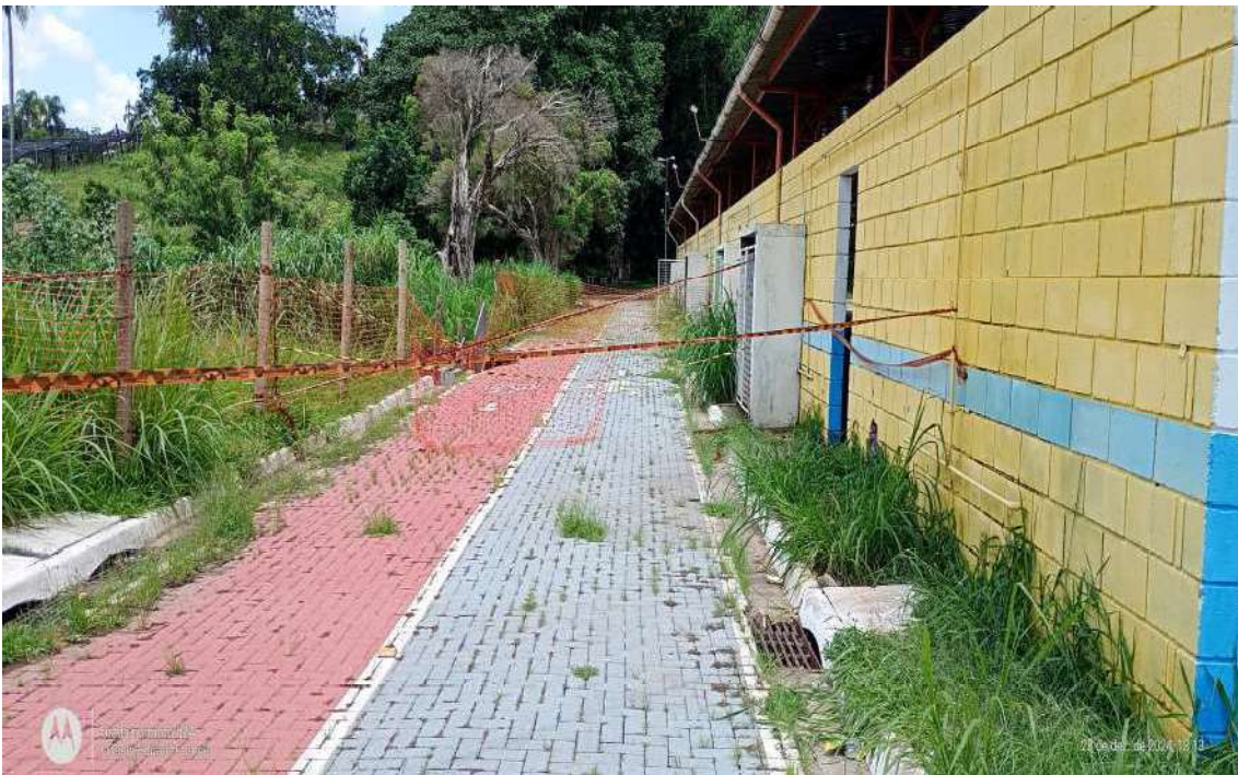
Imagem 05 – Processo de Erosão Hídrica – Área de Lazer do Trabalhador
