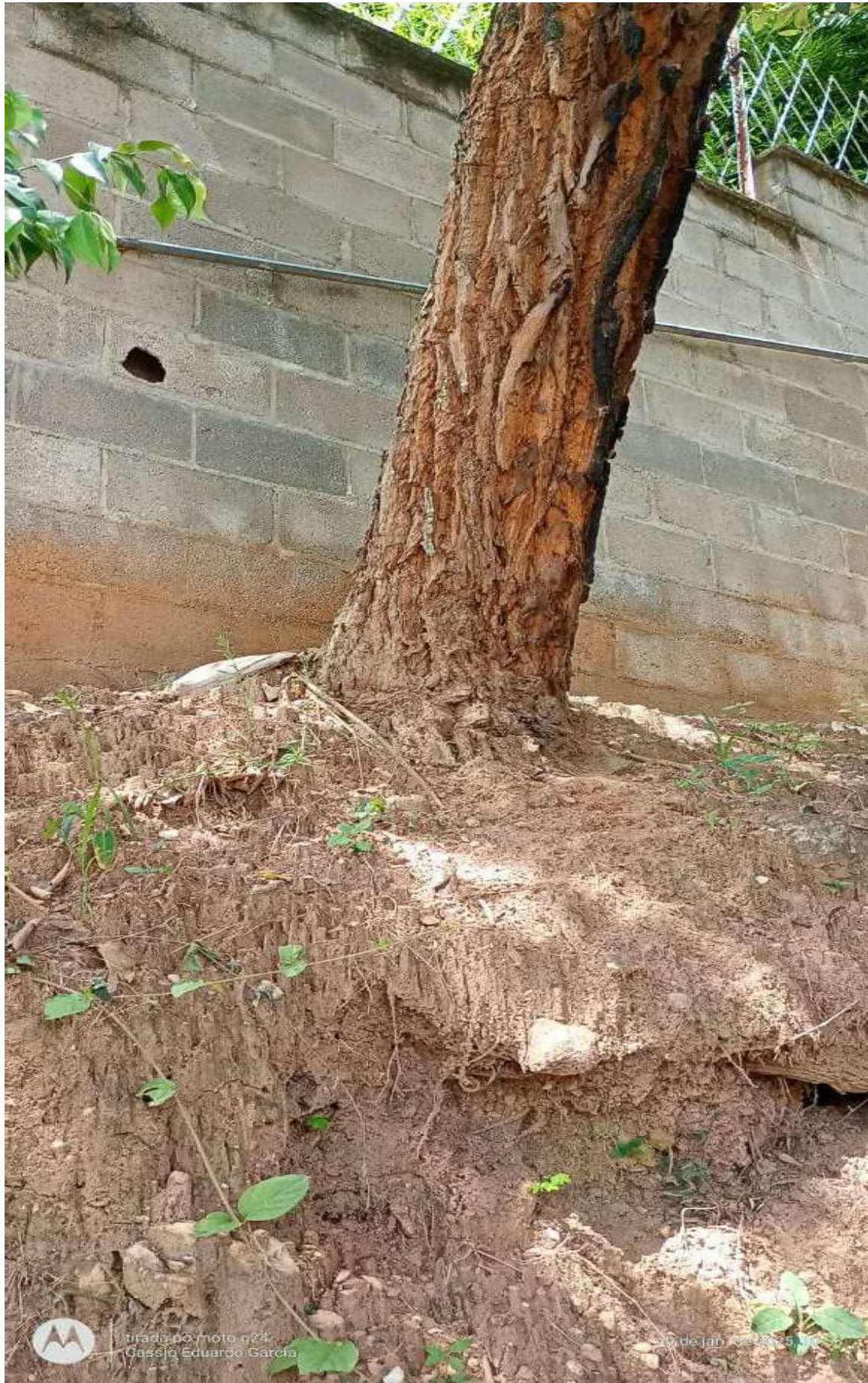
Imagem 02 – Árvore com Risco de Queda – Condomínio Piccolo Villaggio
